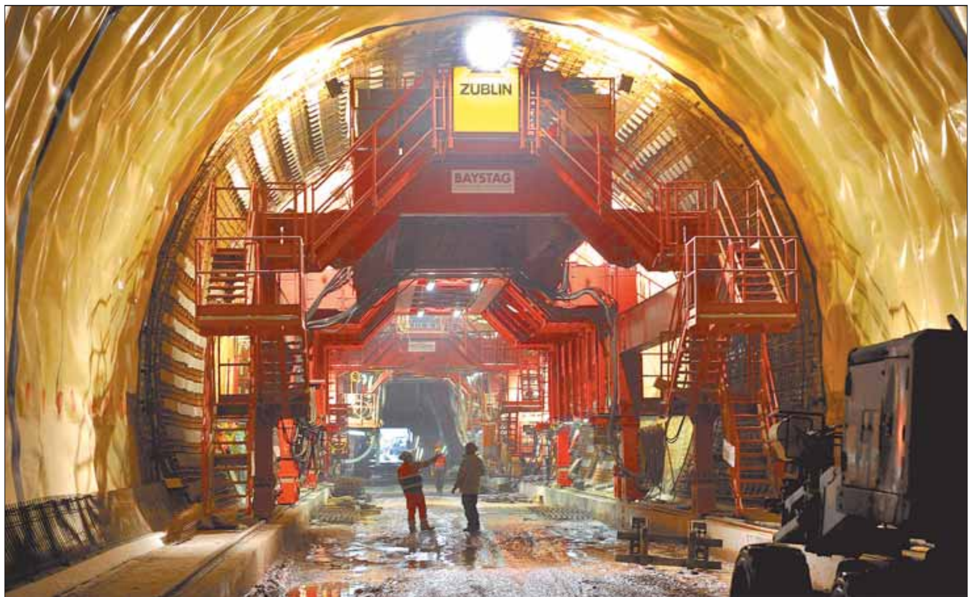
Weil das Regenwasser durch den Branich sickert, muss der Tunnel vor dem Innenausbau komplett abgedichtet werden. Die gelbe Folie bedeckt bereits ein gutes Stück des ausgesprengten Hohlraums. Dann folgt die Stahlbewehrung mithilfe des im Bild zu sehenden Bewehrungswagens. Schließlich folgt der Schalwagen, der täglich zwölf Meter Tunnelwand betoniert. Fotos: Dorn
